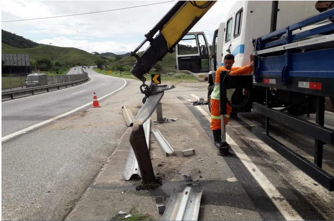
Figura 6.4 ViaLagos - Dispositivo de Segurança - Km 8+300 Sul F2
